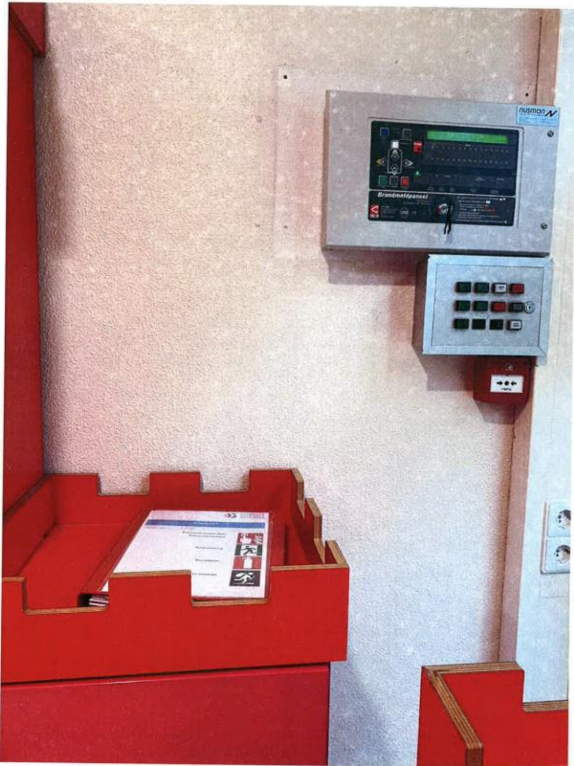
Locatie: Brandmeldinstallatie bedieningspaneel begaande grond bij de printer in de hal
